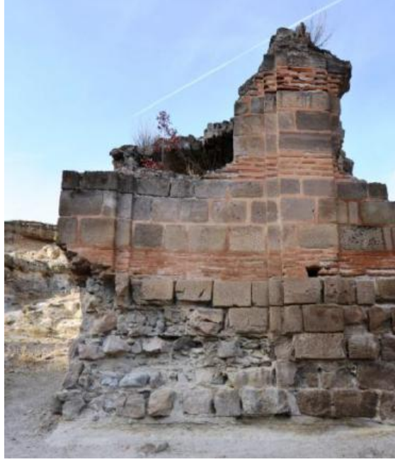
Şekil 15: Batı Cephedeki Yuvarlak Kemerli Çökertme Yüzey (12.11.2016)
